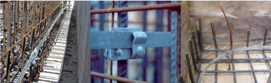
Εικόνα 8. Θεμελιακό Ηλεκτρόδιο Γείωσης εγκατεστημένο στον οπλισμό του κτηρίου [9].
