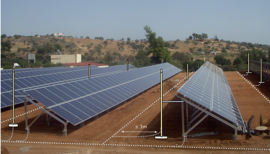
Εικόνα 10: Εγκατάσταση ηλεκτροδίου γείωσης σε απομονωμένο ΣΑΠ με σύνδεση κάθε σειρά συλλεκτήριων συστημάτων συνδέεται σε ξεχωριστή πλευρά του συστήματος γείωσης. Το μεταλλικό πλαίσιο των Φ/Β-στοιχείων γειώνεται με ξεχωριστό αγωγό σύνδεσης [9].
