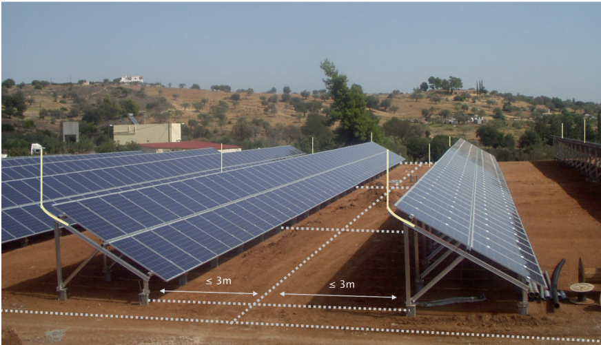
Εικόνα 9:Εγκατάσταση ηλεκτροδίου γείωσης σε μη απομονωμένο ΣΑΠ με σύνδεση δύο σειρών φωτοβολταϊκών στοιχείων σε κοινή πλευρά του πλέγματος γείωσης [9].
